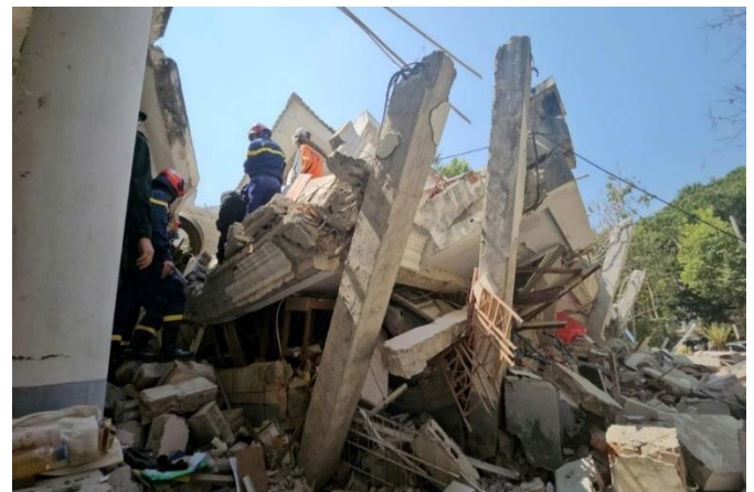
Hiện trường công trình sập đổ do động đất tại Myanmar.
